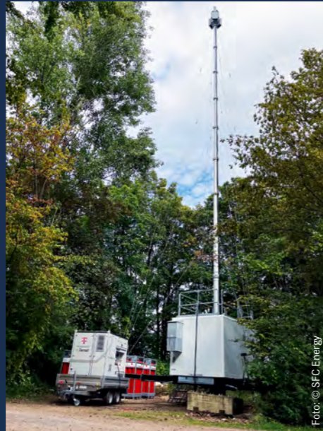
Der Telekom-Mast ist mit grünem Wasserstoff gespeist worden
