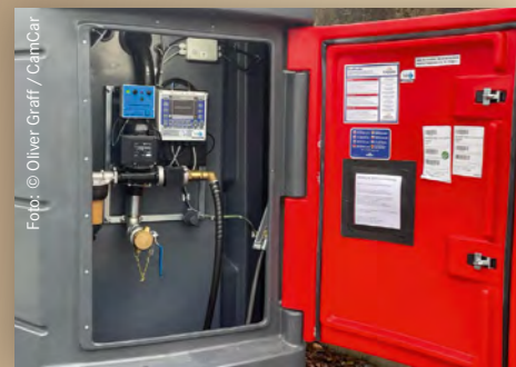
CamCar verfügt über eine eigene HVO-Betriebstankstelle
