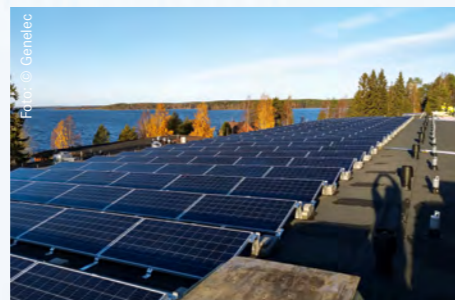
Auf dem firmeneigenen Fabrikdach wird Solarstrom produziert
